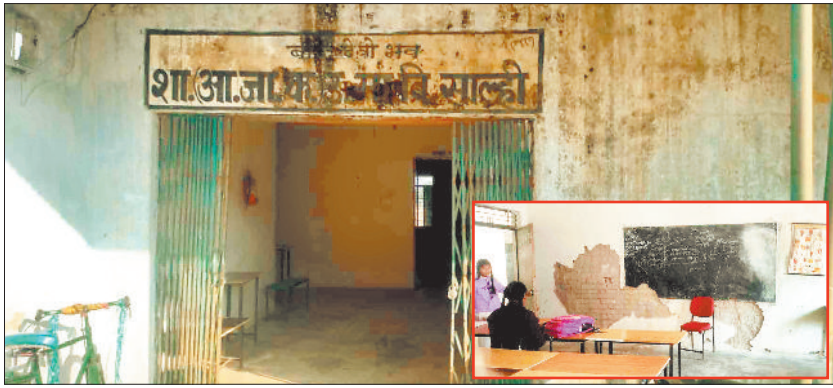
जर्जर स्कूल भवन, इनसेट में दीवार से उखड़े प्लास्टर।
